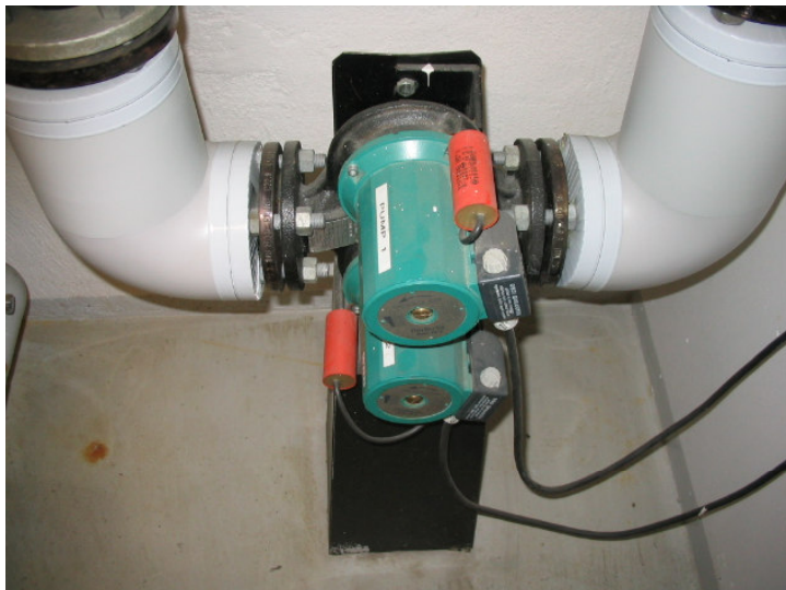
Figur 4.4 Vanligt förekommande installation av cirkulationspumpar.
